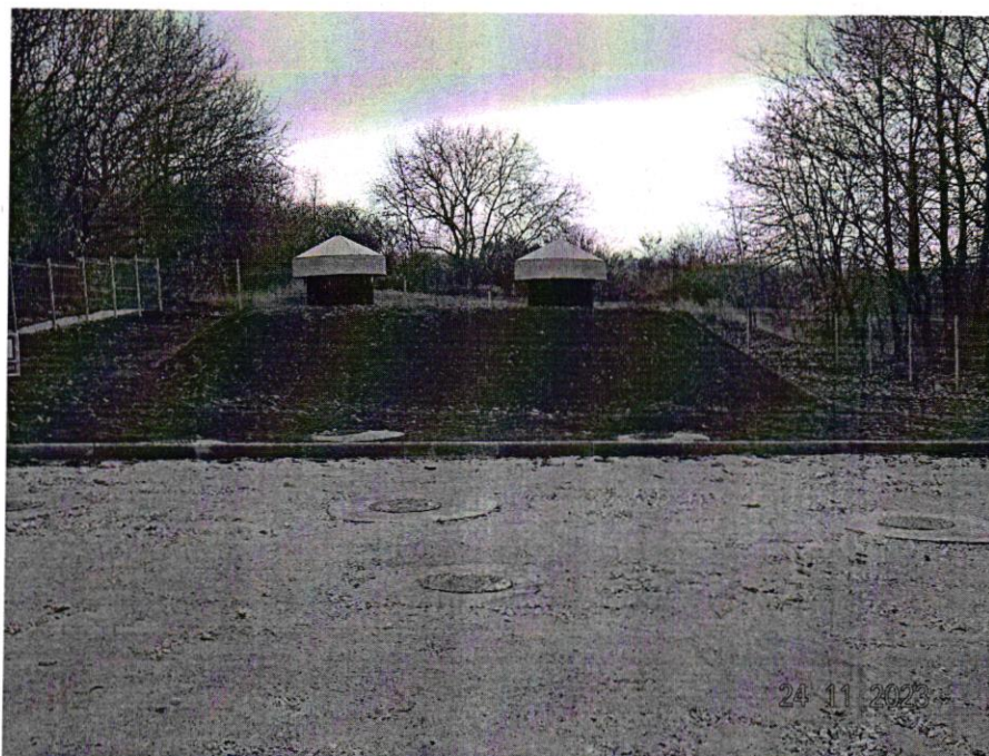
Platforma B: Volovița - 2 rezervoare cu V=50m^3 .
